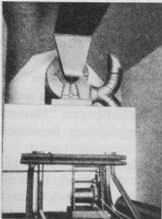
Abb. 38 Kreislauf- und Lüftungseinrichtung einer 400 cbm fassenden Eisenbahntentwesungskammer.
